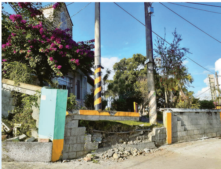
教會外牆損壞狀況
