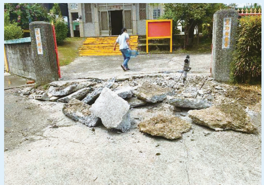
教會正門口損壞狀況
