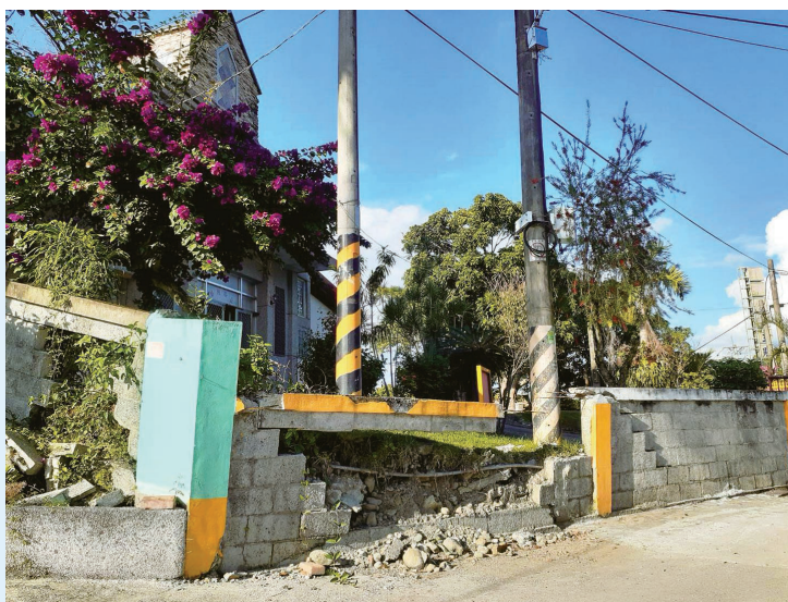
教會外牆損壞狀況
