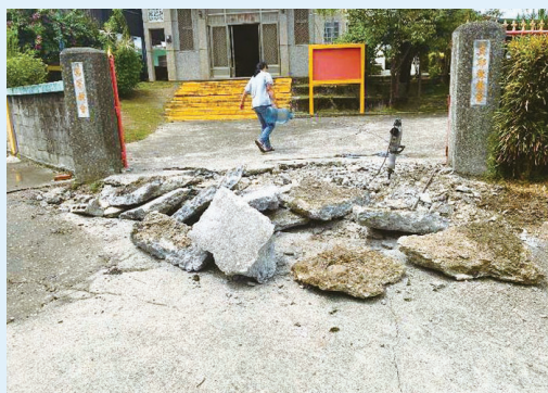
教會正門口損壞狀況
