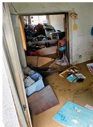
信徒房屋毀損情況
